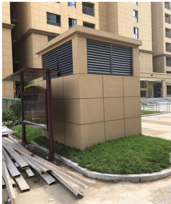
地下室出风口
