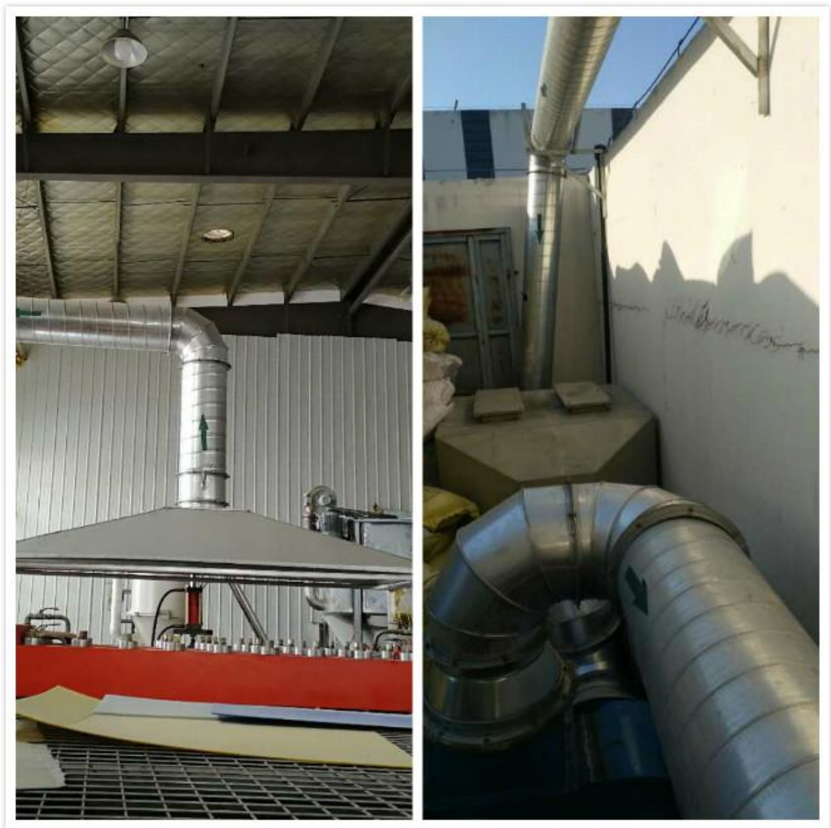
图 4.1-1 废气治理设施照片
